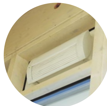
Innenansicht: Der AEROJET® unter dem First des Wintergartens
